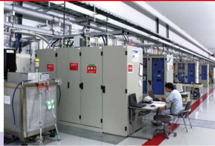
■クライストロンギャラリーには、強力なマイクロ波を発生させる装置であるクライストロンや、それを動かすための電源、制御装置等が、70台並ぶ。
